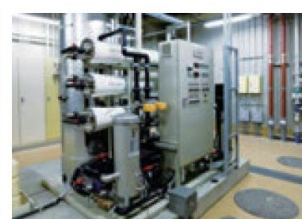
【高度ろ過設備】
