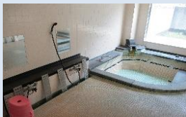
浴室 ・身障者用のスペース等の未整備
