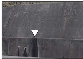
地下水の流出
