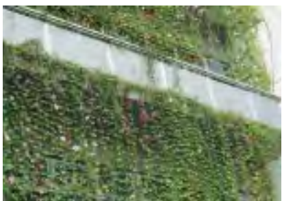
▲壁面緑化（和泉橋出張所）
