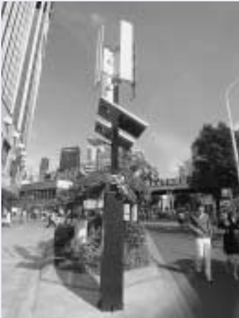
◀風力・太陽光発電型街路灯（有楽町）
