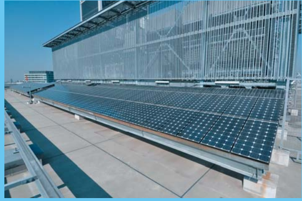
区役所本庁舎屋上の太陽光発電装置
