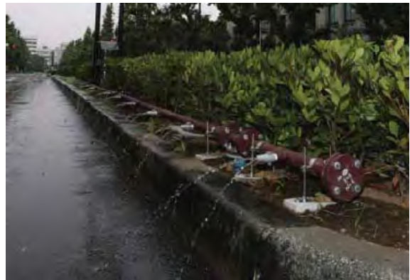
図 散水管からの散水の様子
