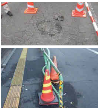
投稿例：道路のへこみや曲がったガードパイプ
