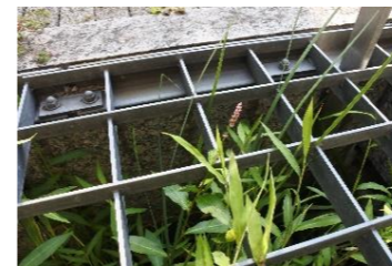
三井住友海上駿河台新館前のレインガーデン 底は土壌となっており、周囲からの雨水を浸透させています 土壌のため植物が生育します
