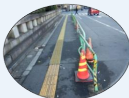
例：曲がったガードパイプ
