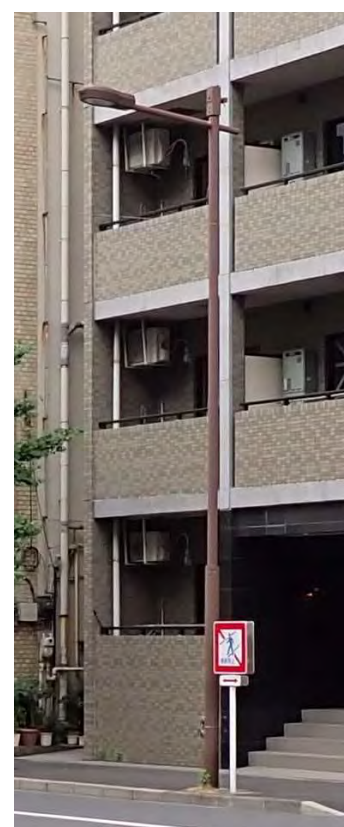
清洲橋通り既設照明 (ナトリウムランプ)
