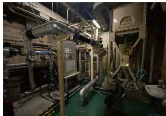
老朽化が進む設備機器
