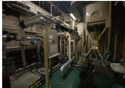
老朽化が進む設備機器
