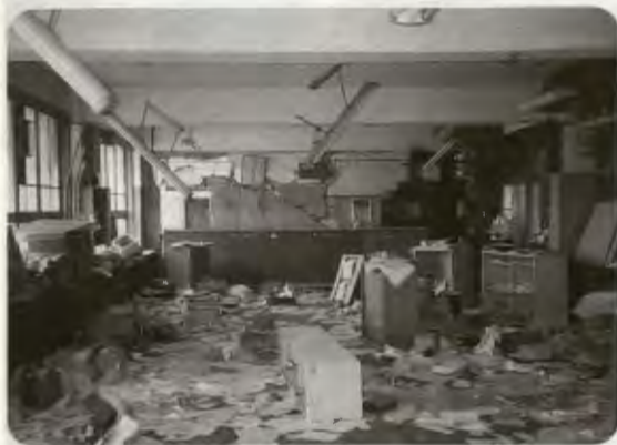
▲職員室の惨状(神戸・本山中)
