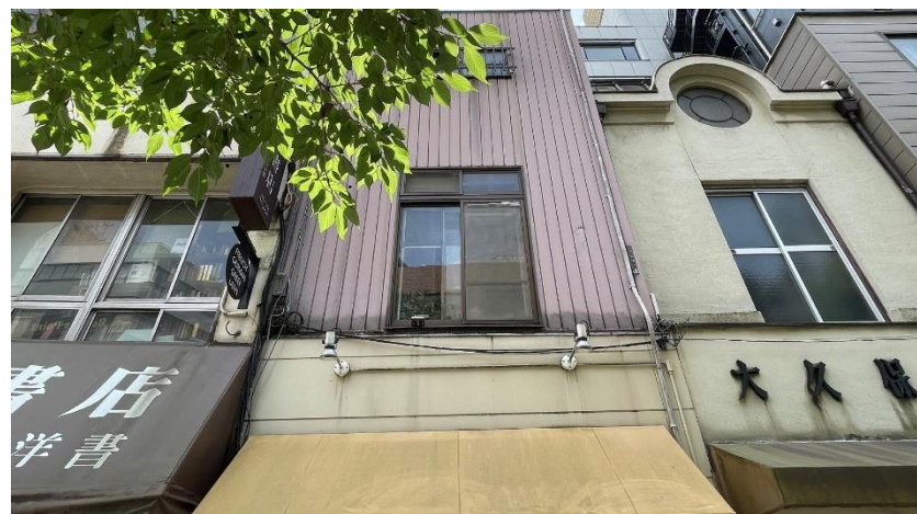
中小規模の建物の老朽化が進行
