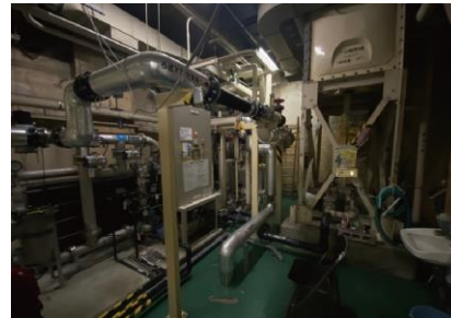
老朽化が進む設備機器
