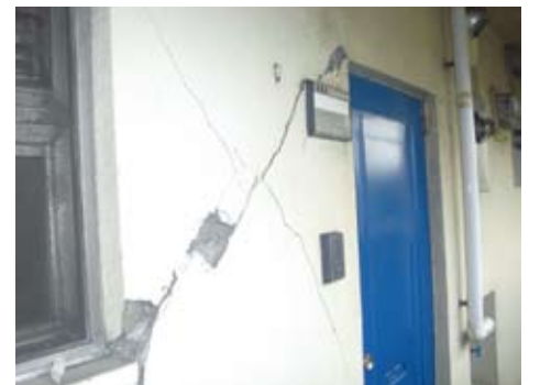
▲壁せん断破壊
